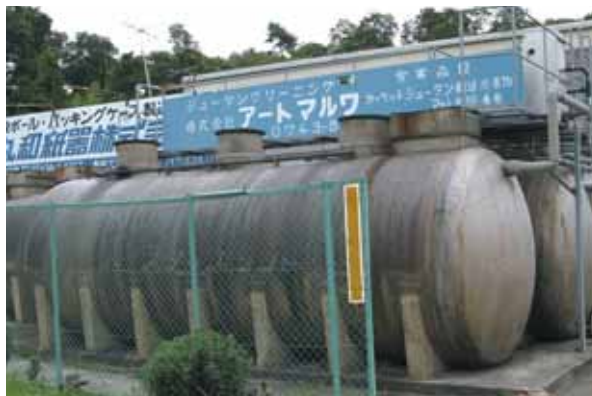
世界一厳しい瀬戸内海排出基準をクリアする廃水処理設備
